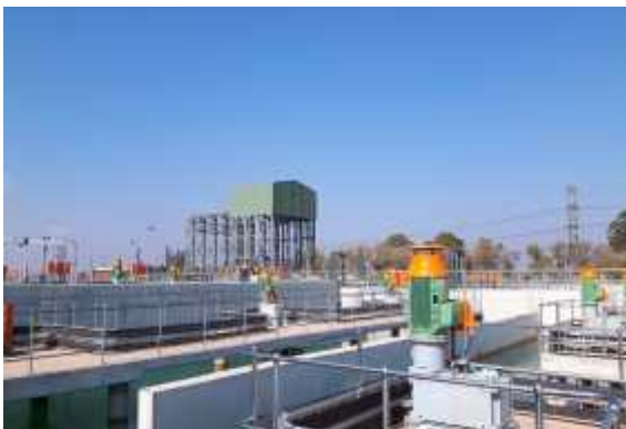
Planta de tratamiento de aguas ácidas de mina. Capacidad 106 millones de litros por día. Johannesburg-Africa del Sur 19.05.2016.
